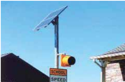
Fig.5 Panel FV instaluar për sinjalizimin rrugor.
