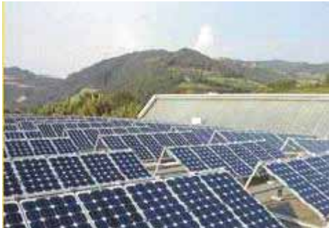
Fig.4 Pamje instalimi të sistemeve FV në Mesdhe.
